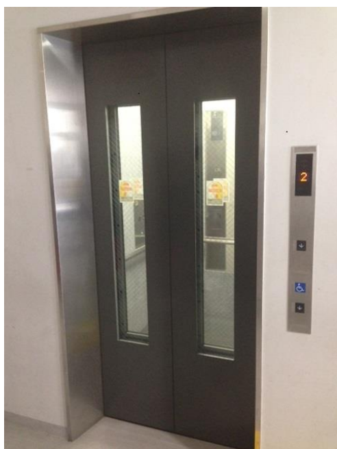
【写真 3】 1 階のエレベータ
